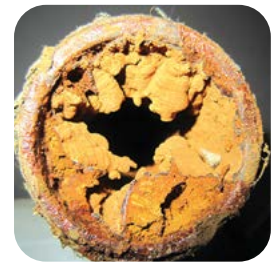
Ruoste- ja kalkkikerrostumaa käyttövesiputkissa
