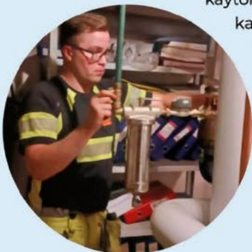
Mikko pannuhuoneessa Bauer-suodatinta vaihtamassa.
