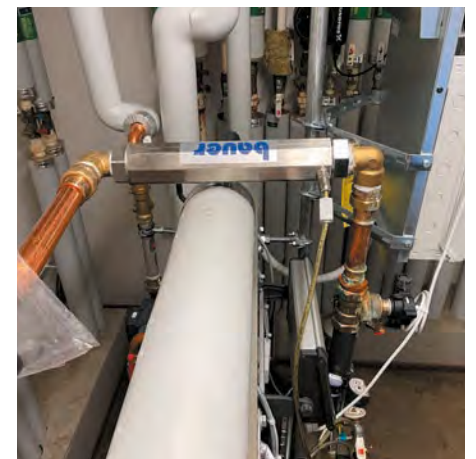
Vedenkäsittelyosa liitettynä lämmitysjärjestelmään
